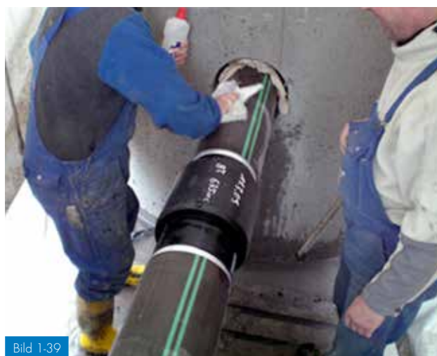
Bild 1-39 Rengöring av rörytan
